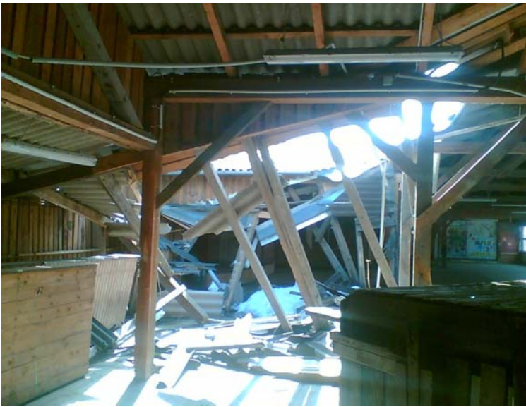
Die Hallenkonstruktion brach unter der schweren Schneelast zusammen
